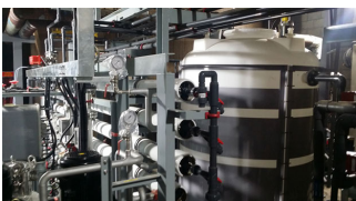
역삼투막·전기 탈이온 수처리장치
